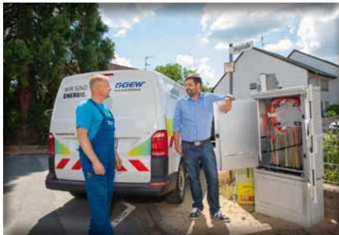
Andreas Hartwig und Matthias Hechler (v. l.) von der GGEW AG an einem Kabelverteiler-Kasten für Glasfaser in Bickenbach.
